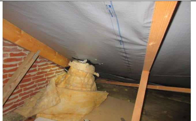
6A Manglende ordentlig tætning ved gennemføring
