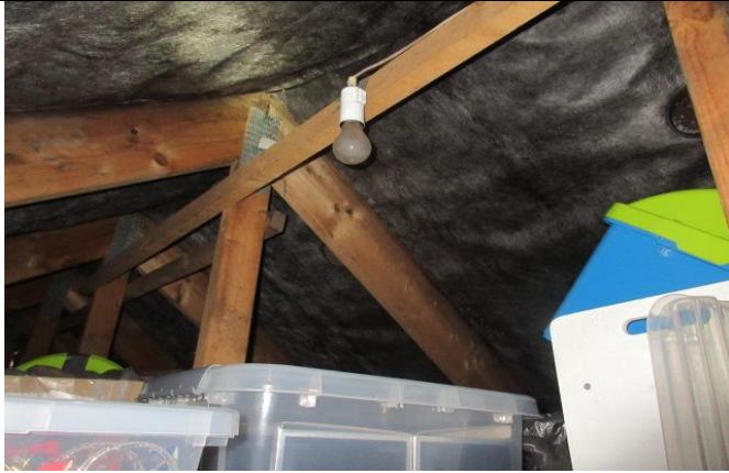
2D Massivt oplag, fugtskader
