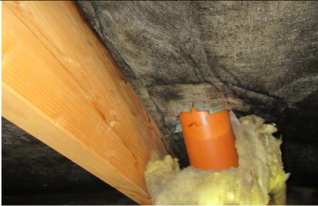
10A Mindre fugtskader ved udluftning mangler ved gennemføring og kondensisolering
