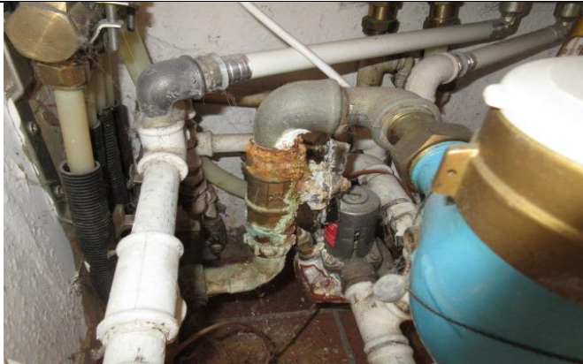
4D Defekt/tæret rør ved vandur, risiko for rørskade, bør udskiftes
