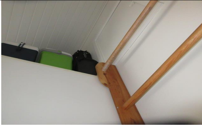
10D Ændret konstruktion ved tidligere tagrum, nuværende fugtskader ved vinduer pga. forholdet. Der henvises til skadesrapport
