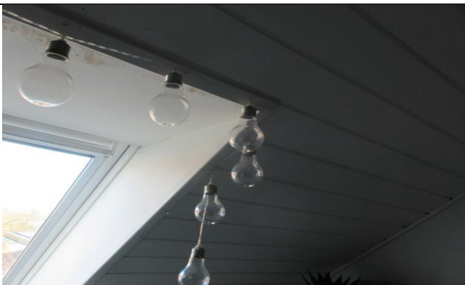
10B Indvendigt ses lysning fugtskadet pga. skader ved taget, der henvises til skadesrapport
