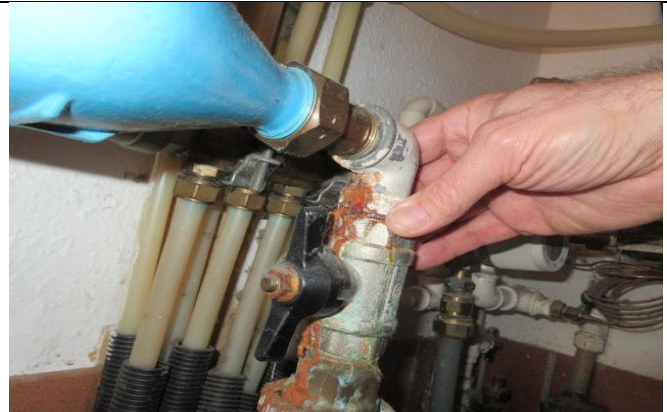
8A Defekt/tæret rør ved vandur, risiko for rørskade, bør udskiftes
