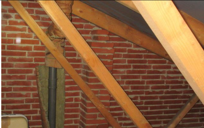
6B Manglende kondensisolering ved kloakudluftning og rørgennemføring
