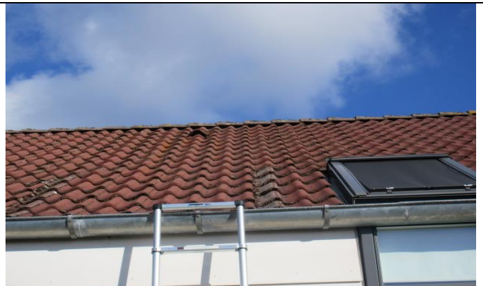
2D Mindre begroninger, tagrende udskiftet, dog er der større bagfald og tagrende hænger en del.
