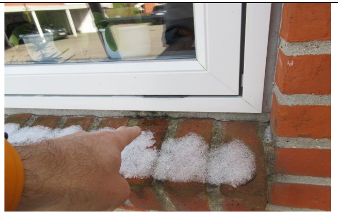
8A Manglende tilbagetrækning af fuger afvandningshuller i vinduesprofil. De steder, der er synlige problemer, bør dette ændres
