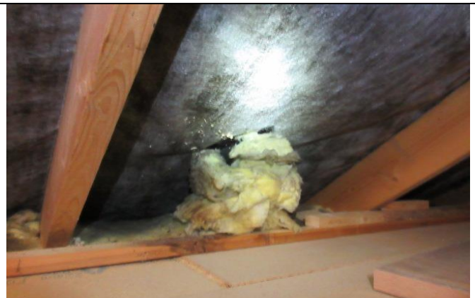
2A Mindre fugtskade ved rørgennemføring, manglende tætning og kondensisolering
