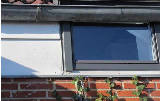
10A Utætheder ved tagrende samlinger og enkelte steder med revner i tagrender, specielt ved indvendige kanter, hvor der er bagfald
