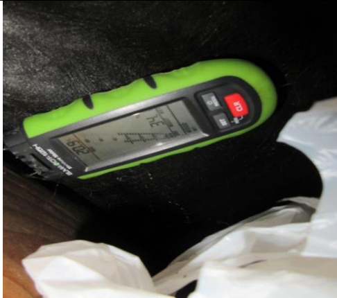
2B Målt forhøjet fugt på 34 procent.
