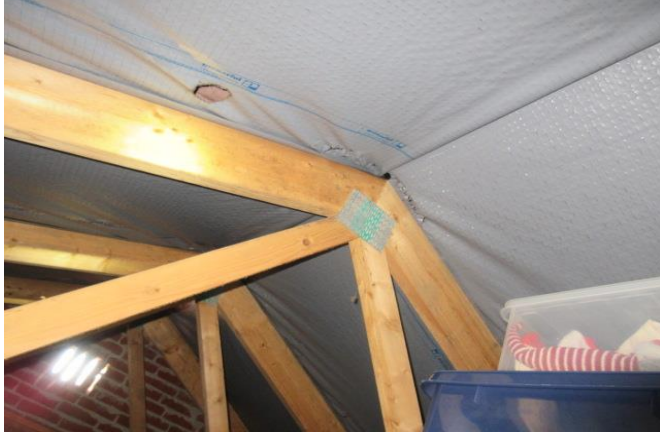
4B Slidskader og manglende lukning ved ventil
