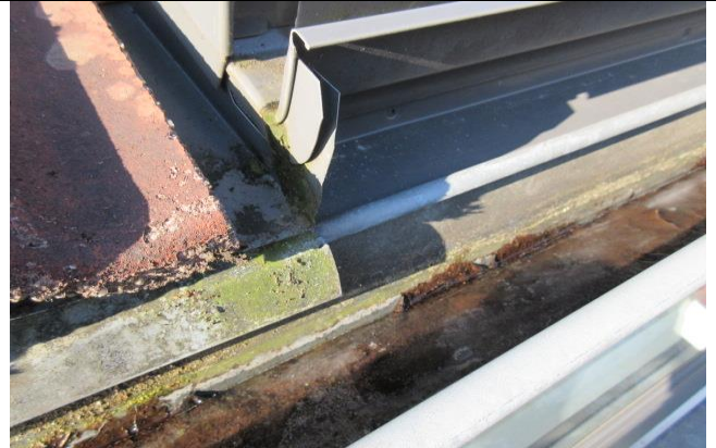
10A Inddækninger ses dog renholdt, vigtigt at dette kontrolleres løbende.
