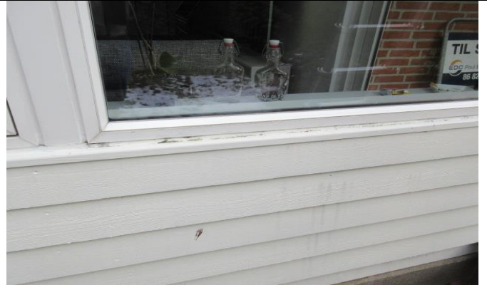
4C Manglende afstand og tilbagetrukket fuger ved træbeklædning og underkant af vindue
