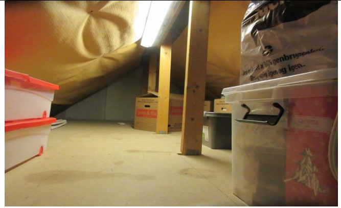
10D Isoleret loftsrums, mangelfulde afslutninger ved konstruktion, der påregnes mangelfuld ventilationspalte mellem efterisolering og oprindeligt undertag samt manglende udluftning ved konstruktion
