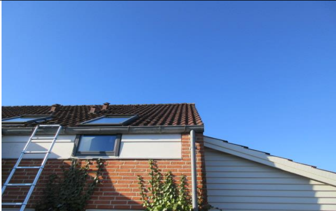
10A Ovenlys er monteret i taget, inddækning ved taget/undertagskraver er oplyst ikke værende udført i henhold til gældende krav af tidligere (TØ)
