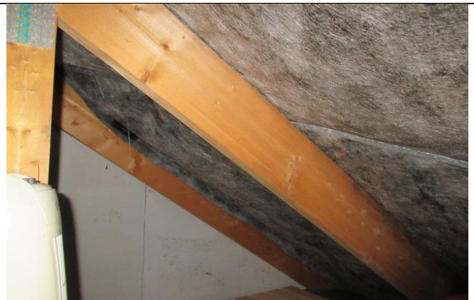
10A Primært god udluftning, enkelte fugtspor ned mod skråvægge
