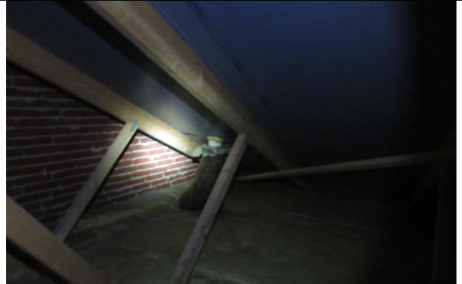
8A Manglende manchette ved rørgennemføring
