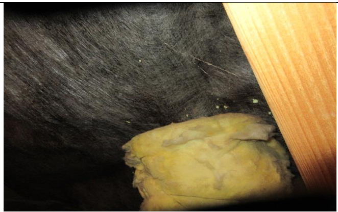
2C Manglende manchetter ved gennemføring
