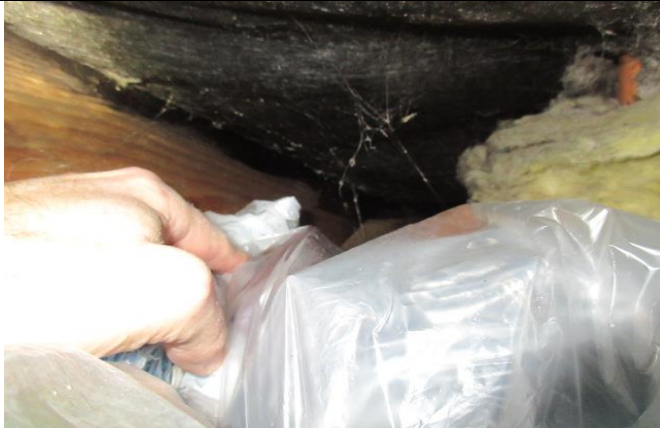
2B Meget oplag i tagrum, fugtskader manglende udluftning
