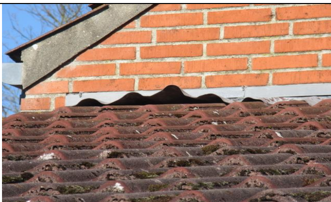
2A og 2B Defekt inddækning tagsten og inddækning rettes
